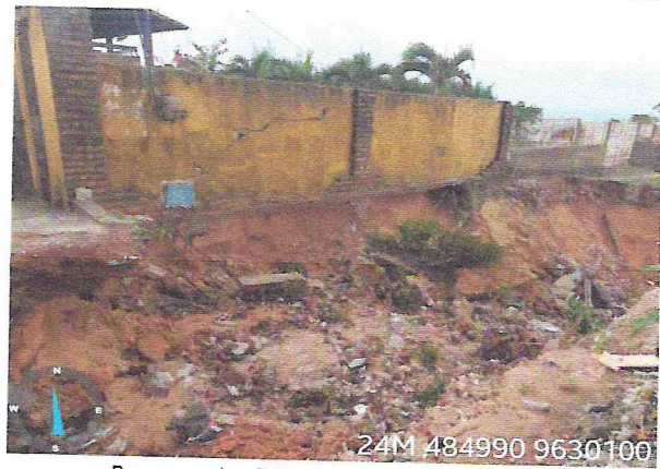
Dano causado a Terceiros e risco de desabamento
