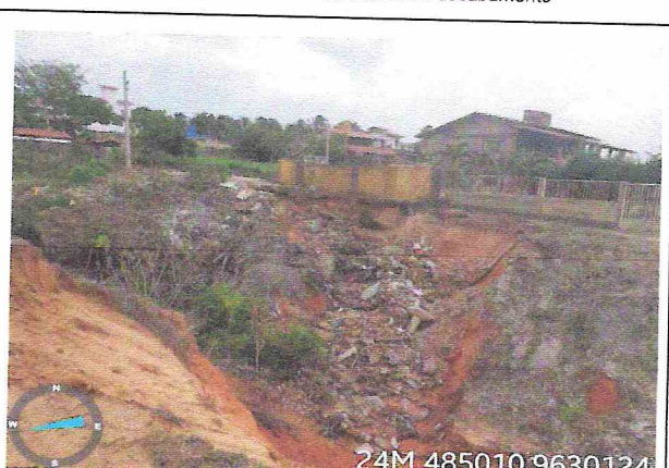
Material a ser removido da erosão para reaterro
