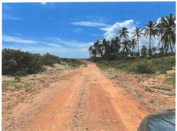
Vista geral da estrada e do trecho a ter substituição de material
