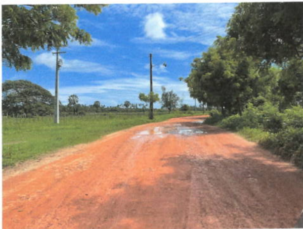
Vista geral da estrada com problemas de drenagem
