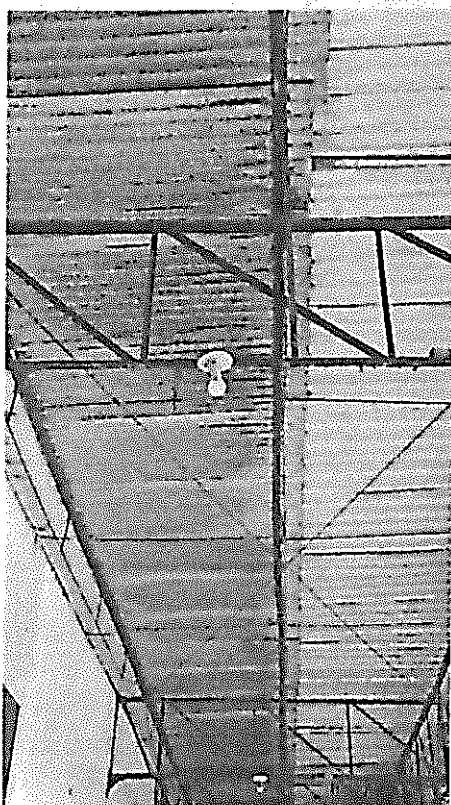
Estrutura de cobertura danificada – Setor de pontos comerciais.
