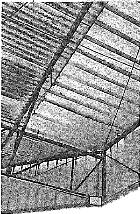
Estrutura de cobertura danificada – Setor de pontos comerciais.
