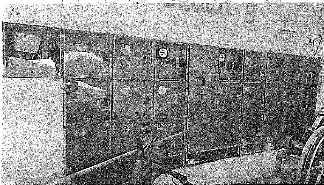
Quadros elétricos – Mercado dos cereais, bloco B.
