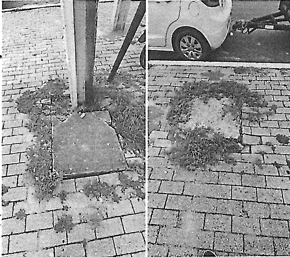
Caixa elétrica – Pátio principal.
