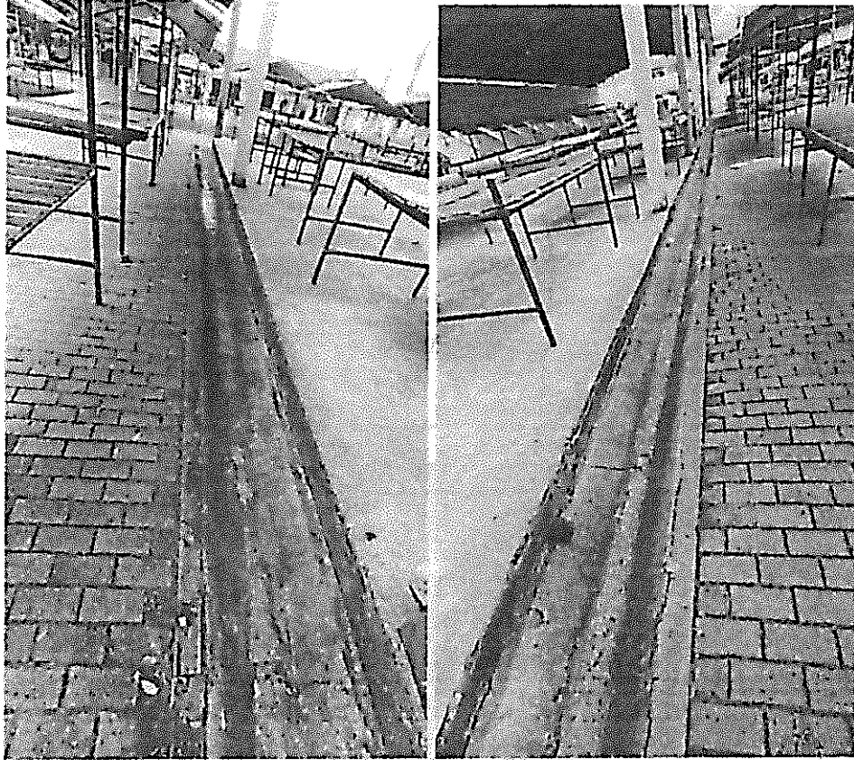
Sistema de esgotamento e drenagem do Mercado da carne.
