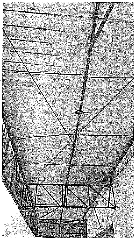
Grande quantidade de telhas com furos.
