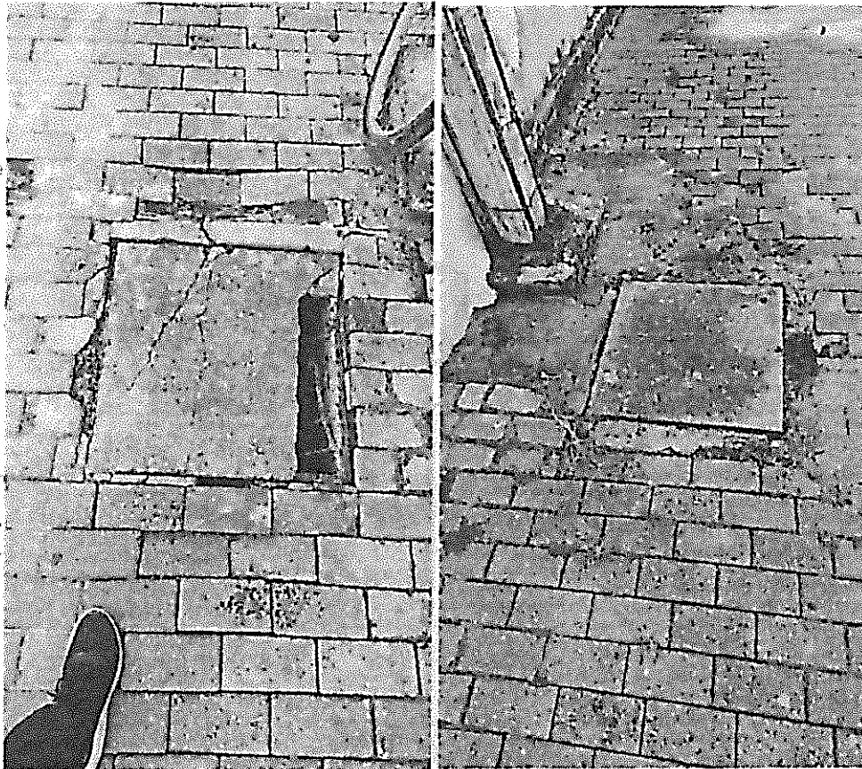
Caixa de passagem – passeio.
