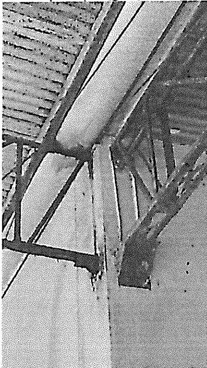
Calha com muitos vazamentos.
