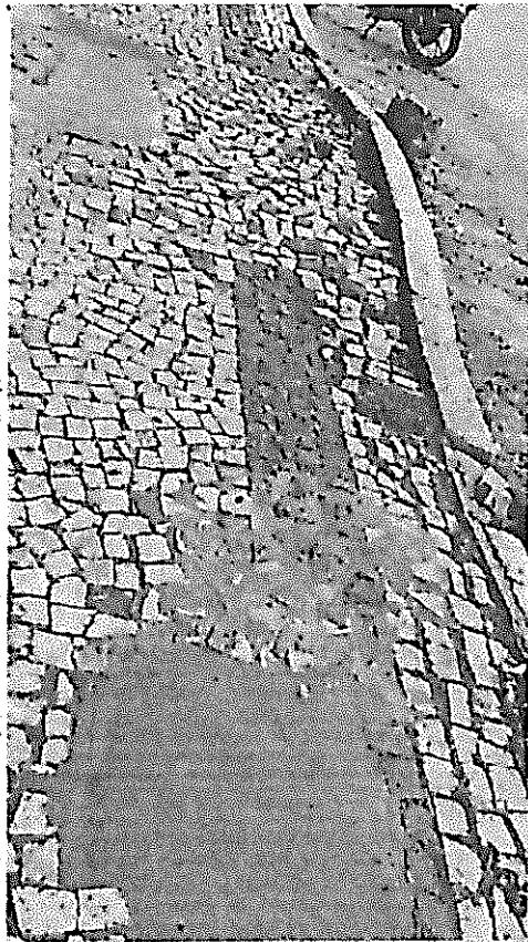
Piso em pedra portuguesa, muito danificado.
